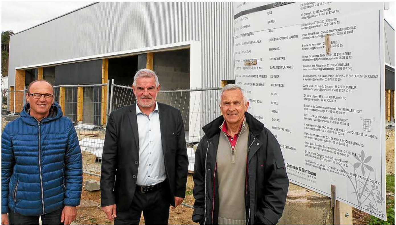
(De gauche à droite) Jean-François Cartron, responsable du pôle technique et contrôleur des travaux en cours, Patrick Piquet, conseiller municipal chargé des travaux, et Gérard Cherouvrier, adjoint chargé des affaires économiques.
